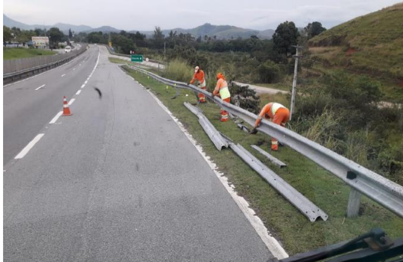
Foto 4 – Dispositivo de Segurança – Km 15+200 Sul
