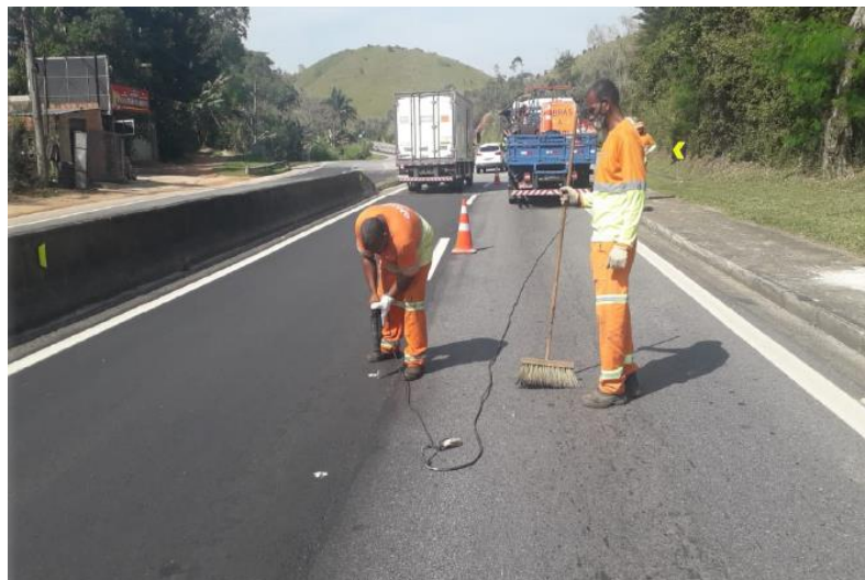
Foto 3 – Dispositivo de Segurança – Km 1+600 Norte
